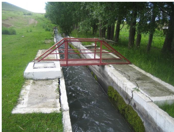
Измерительное устройство расхода воды на межхозяйственном канале
