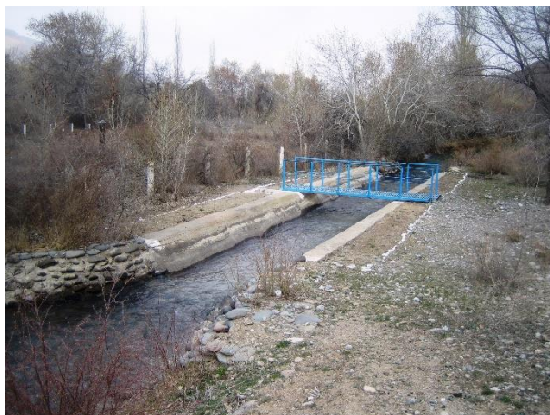
Измерительное сооружение расхода воды в головной части межхозяйственного канала
