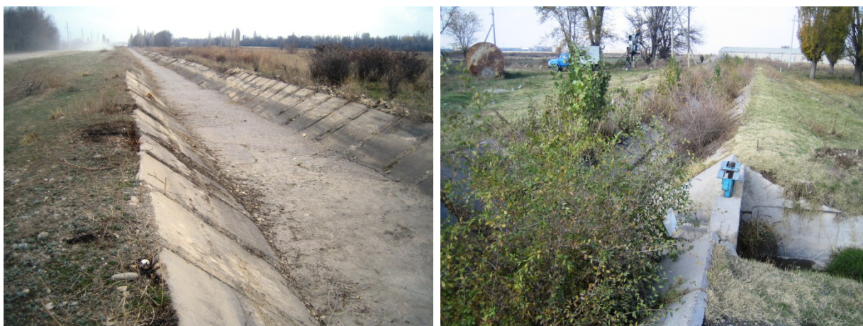
Межхозяйственный канал в Таласской области нуждающийся в реабилитации (слева) и плохо обслуживаемый внутрихозяйственный канал в Чуйской области (справа)
