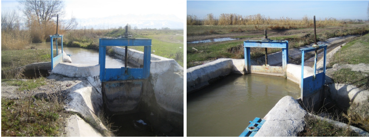
Водозаборное сооружение в начале независимой внутрихозяйственной ИиД системы в Чуйской области
