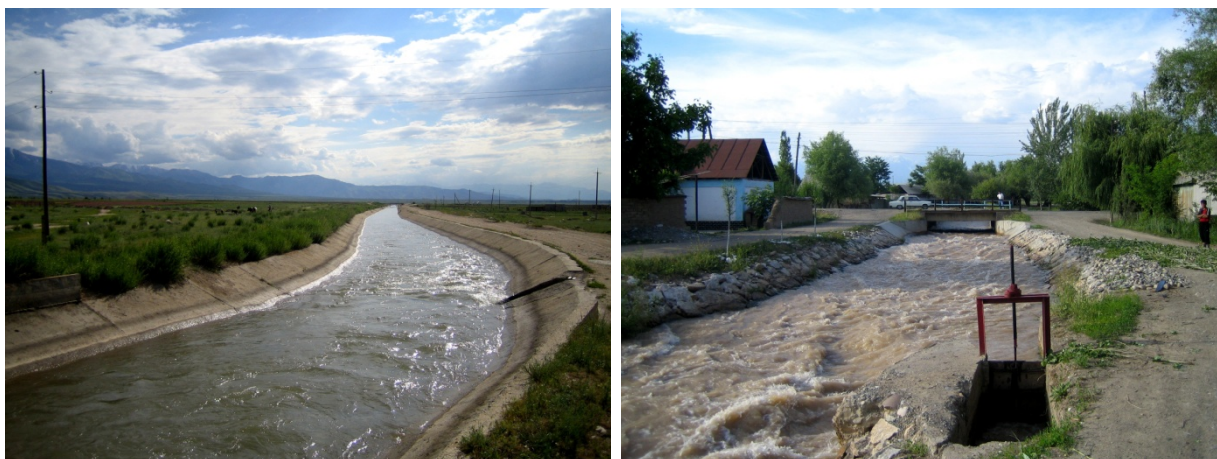
Реабилитированный межхозяйственный канал в Таласской области (слева) и нереабилитированный межхозяйственный канал в Жалалабадской области (справа)
