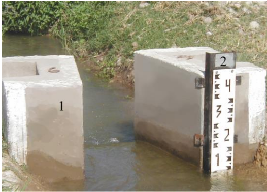
Рис. 5. Водомерный лоток САНИИРИ, подводящая часть 1 – входные открылки, 2 - гидротехническая рейка
