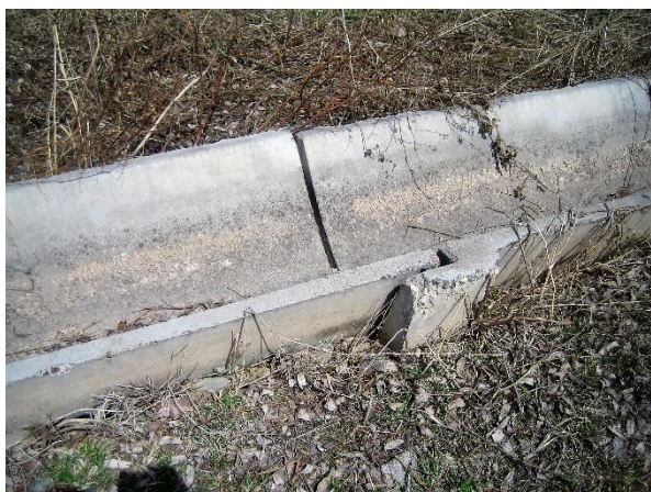
отсутствие прокладки (пороизола) подводящего канала
