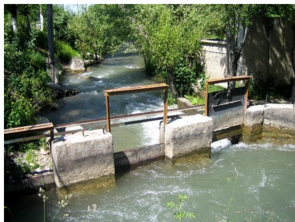
шлюз-регуляторы на необлицованном канале в Ошской области
