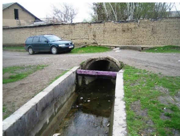
водопропускная труба в Ошской области
